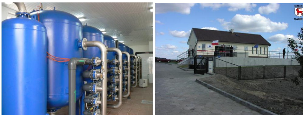
Rys. 10 Stacja uzdatniania wody oraz oczyszczalnia ścieków w miejscowości Narew
