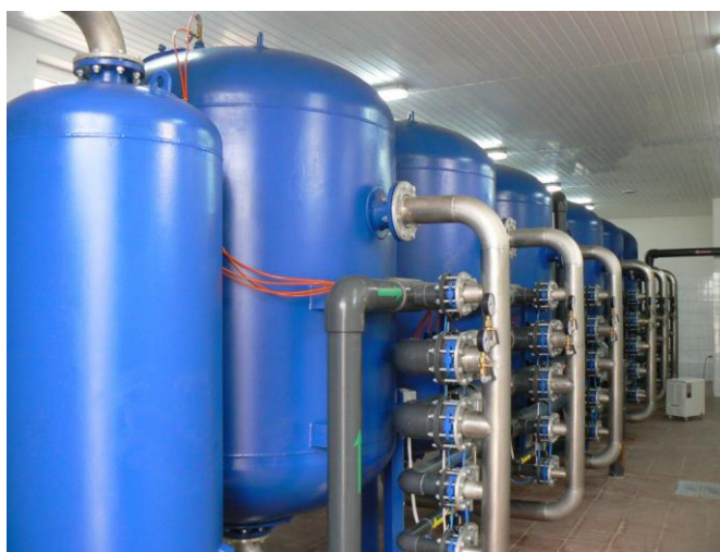
Rys. 10 Stacja uzdatniania wody w miejscowości Narew
